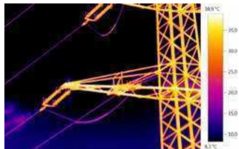
Тепловизионная съемка токового контура на концевой анкерной опоре ЛЭП (расстояние до объекта примерно 120 м)
