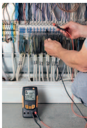
Проверка напряжения в распределительном щитке
