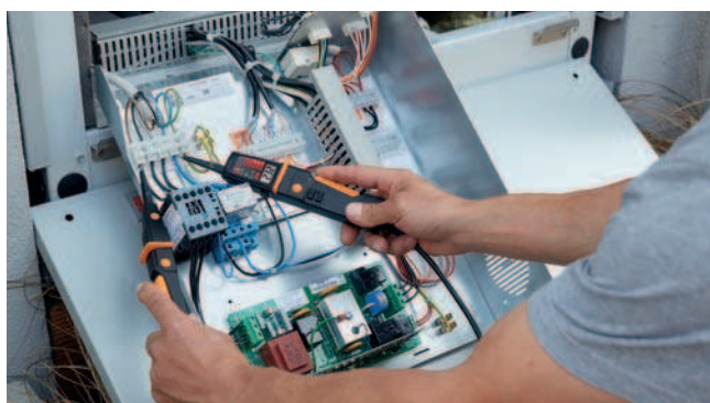
Измерение напряжения на компрессоре
