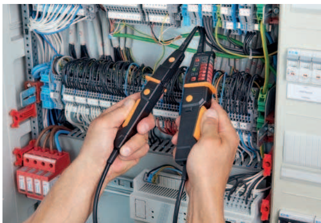
Измерение напряжения в распределительном щитке
