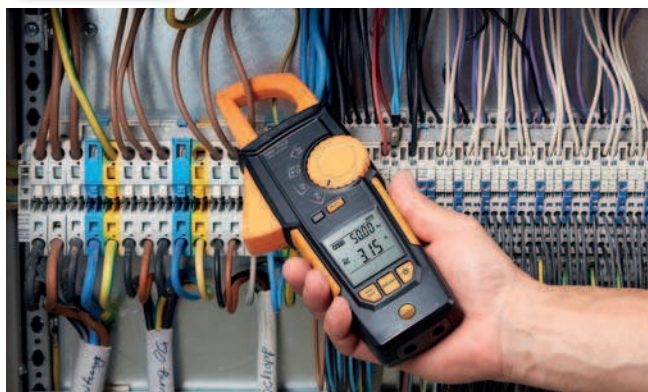
Измерение силы тока в распределительном щитке
