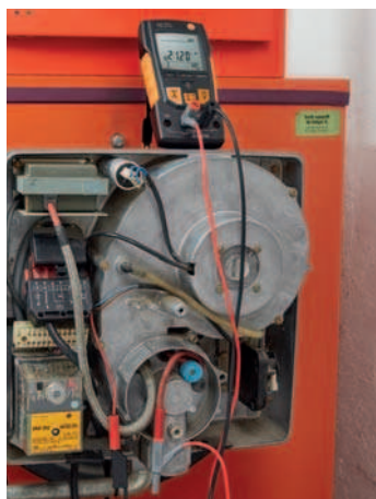
Измерение потока ионизации с testo 760
