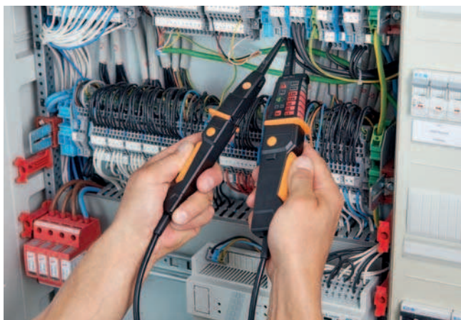
Измерение напряжения в распределительном щитке
