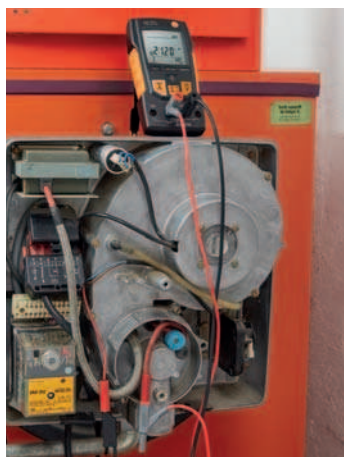
Измерение потока ионизации с testo 760
