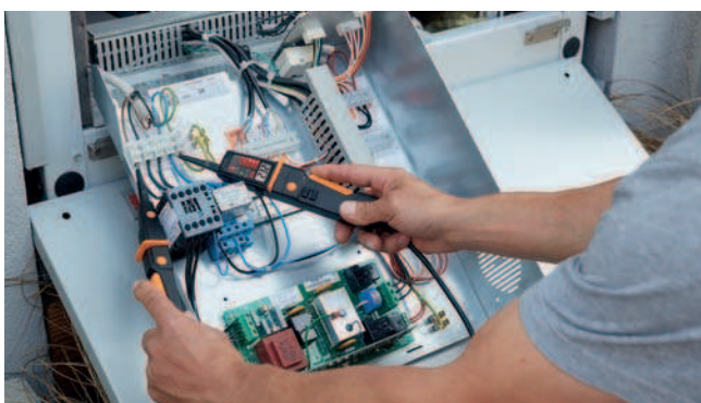
Измерение напряжения на компрессоре
