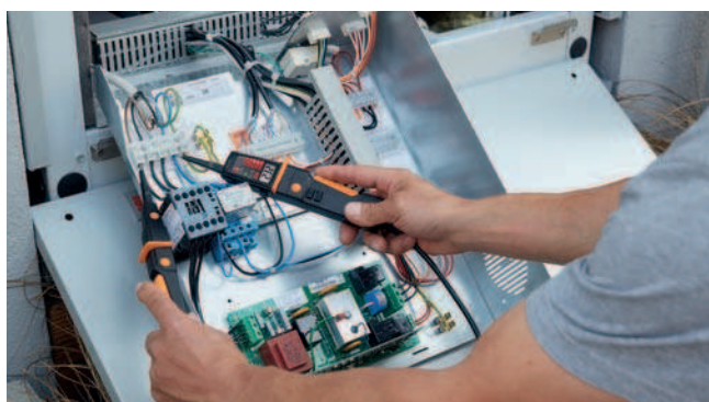
Измерение напряжения на компрессоре
