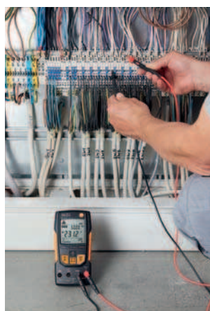
Проверка напряжения в распределительном щитке
