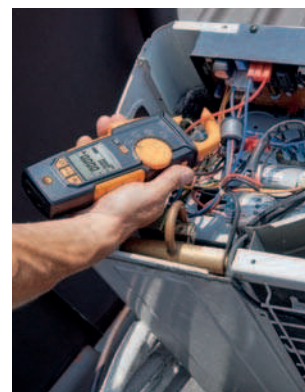
Подвешивание токоизмерительных клещей к наружному блоку холодильной установки
