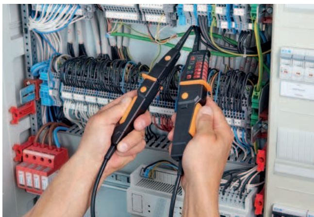
Измерение напряжения в распределительном щитке
