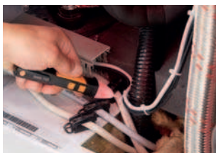
Первый тест подачи напряжения на компрессоре
