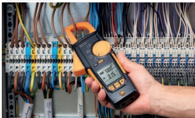
Измерение силы тока в распределительном щитке
