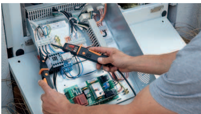
Измерение напряжения на компрессоре
